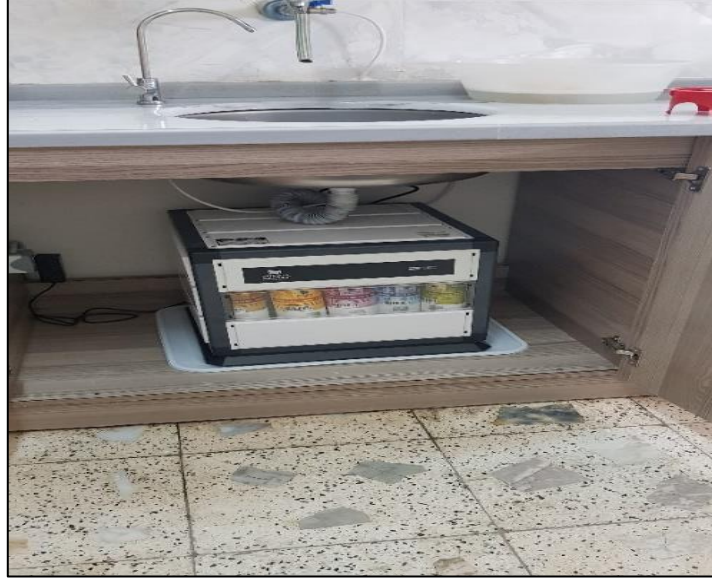
Şekil 6. Durağan MYO binası çay ocağı musluk altı arıtma cihazı
